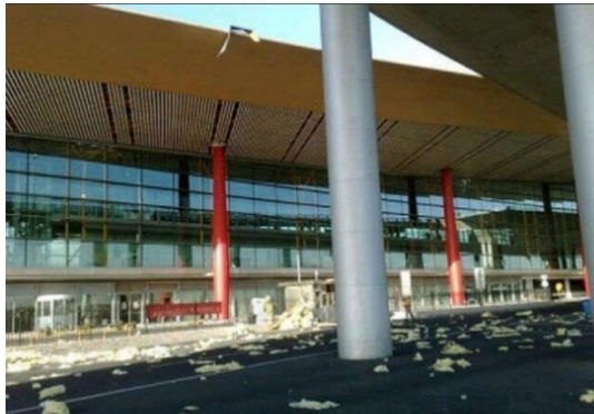
(b) 北京首都机场 T3 航站楼屋面破坏
